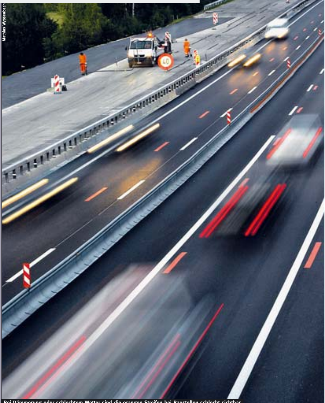
Bei Dämmerung oder schlechtem Wetter sind die orangen Streifen bei Baustellen schlecht sichtbar.
