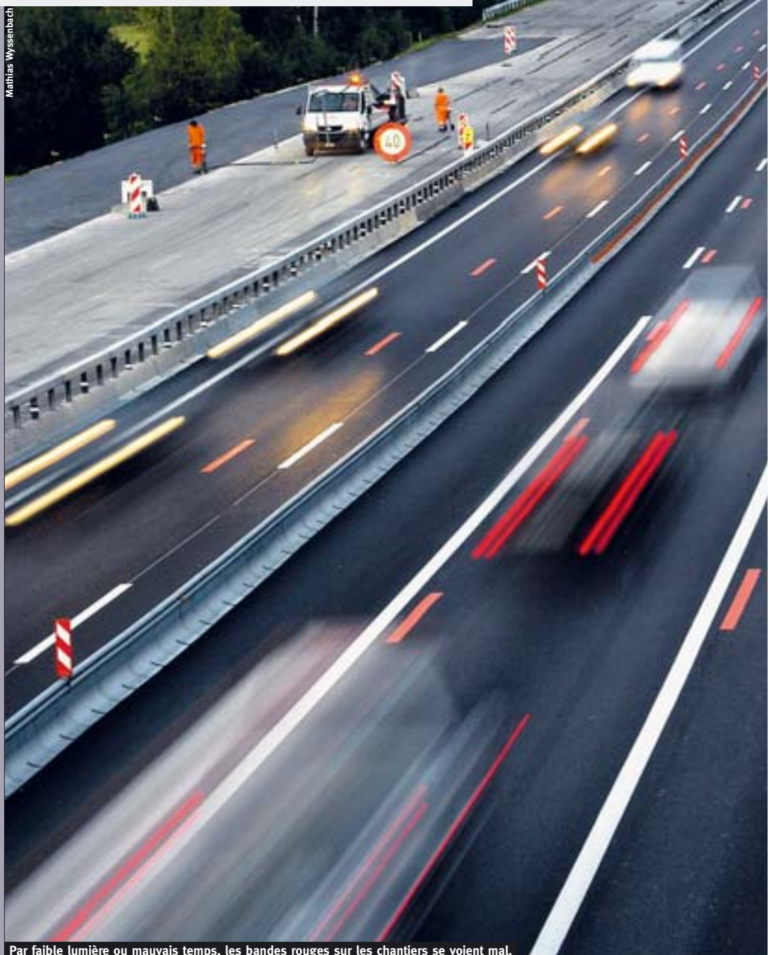
Par faible lumière ou mauvais temps, les bandes rouges sur les chantiers se voient mal.
